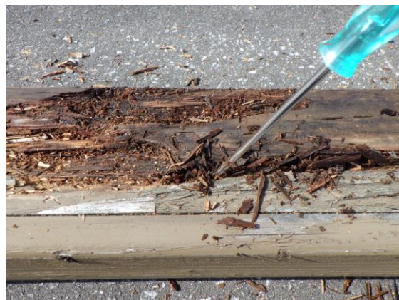
図-4 山形鋼との接触面に発生した木部腐朽の例（6スパン目の下段中央付近）
