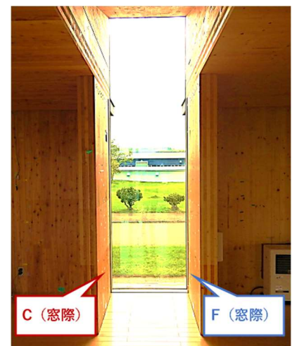
写真9 パネルCおよびFに隣接する開口部
