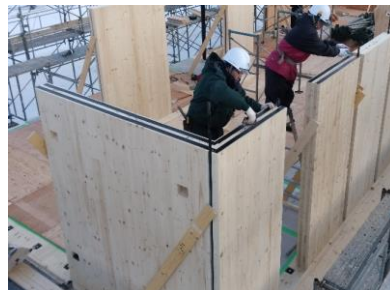
写真 2 壁-屋根取り合い
