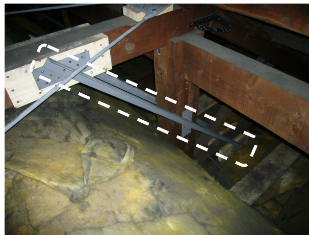
図-6 小屋裏から見た鋼製方杖部材 (図-5の破線で囲まれた部材)
